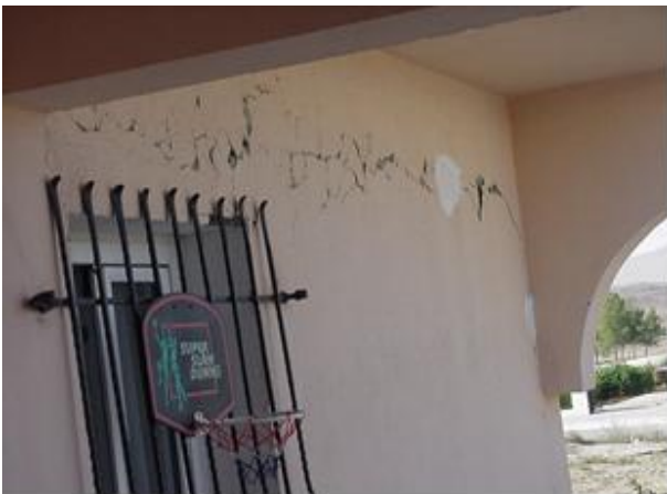
Şekil 1. Lefkoşa'da şişen kil hasarları
