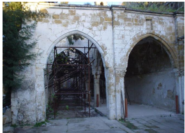
Şekil 3. Ermeni Kilisesi hasarları
